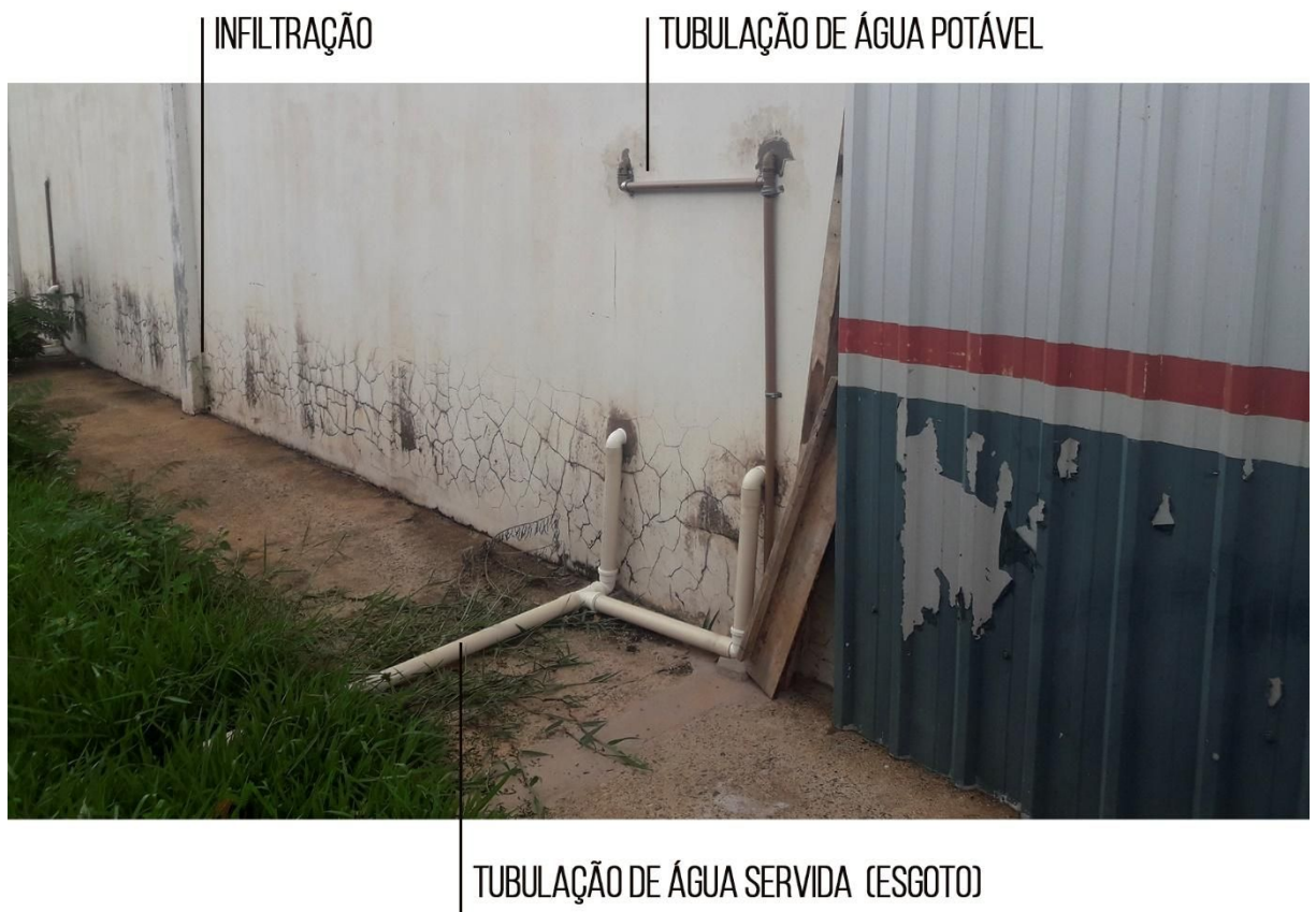
Figura 6 - Tubulações do galpão (Fonte: Imagem dos autores e editada pelos mesmos)
